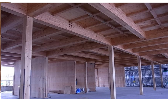
中断面集成材と住宅用梁受金物による6mグリッド2階床組+高倍率耐力壁
