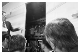
ガスエンジン発電ユニット
