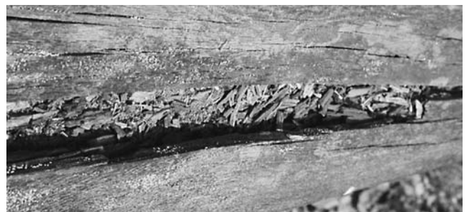
図6 木材保存剤が未注入の内部に生じた腐朽
