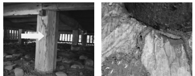
図2 写真左：地面から土台に上がってきた蟻道（図中矢印） 写真右：蟻道の中にいた職蟻
