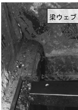
写真5 梁端溶接部の脆性破断
