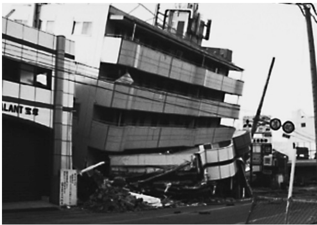
写真1 倒壊した6層建物
