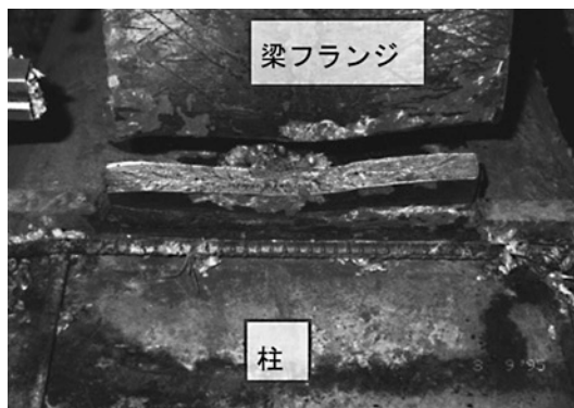
写真6 梁端溶接部の脆性破断
