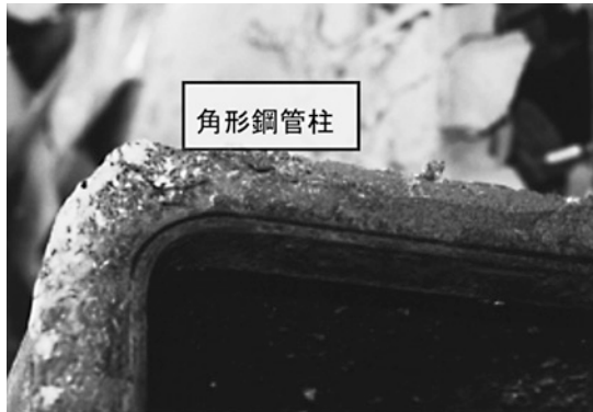
写真3 写真1の柱溶接部の破断面
