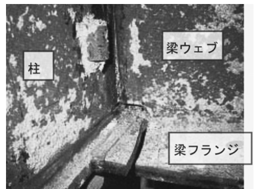
写真7 梁端溶接部の脆性破断
