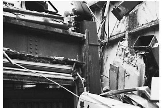
写真4 柱隅肉溶接部が破断して倒壊した建物
